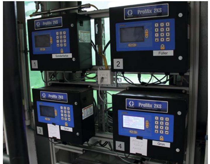
Das System verfügt über ein erweitertes Berichtswesen zum Speichern und Verwalten aller Prozess- und Betriebsparameter. Quelle (zwei Fotos): Redaktion
