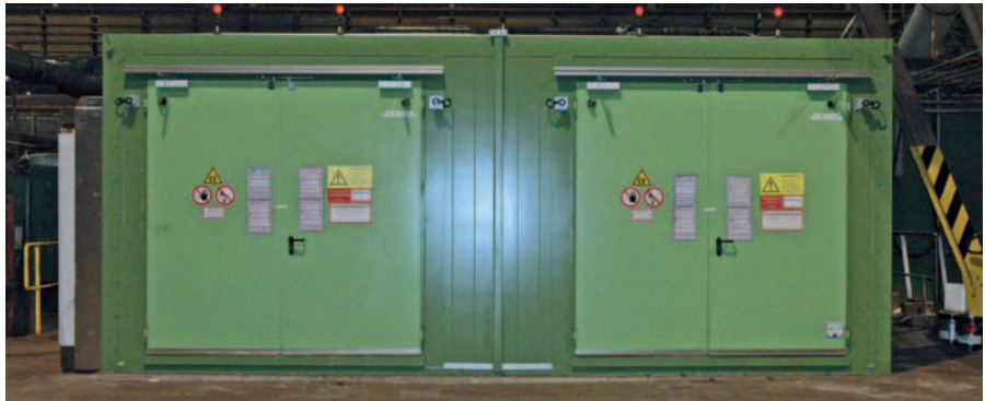
Der Brandschutzcontainer verfügt über autonome Lüftungssysteme und eine CO 2 -Löschanlage.
