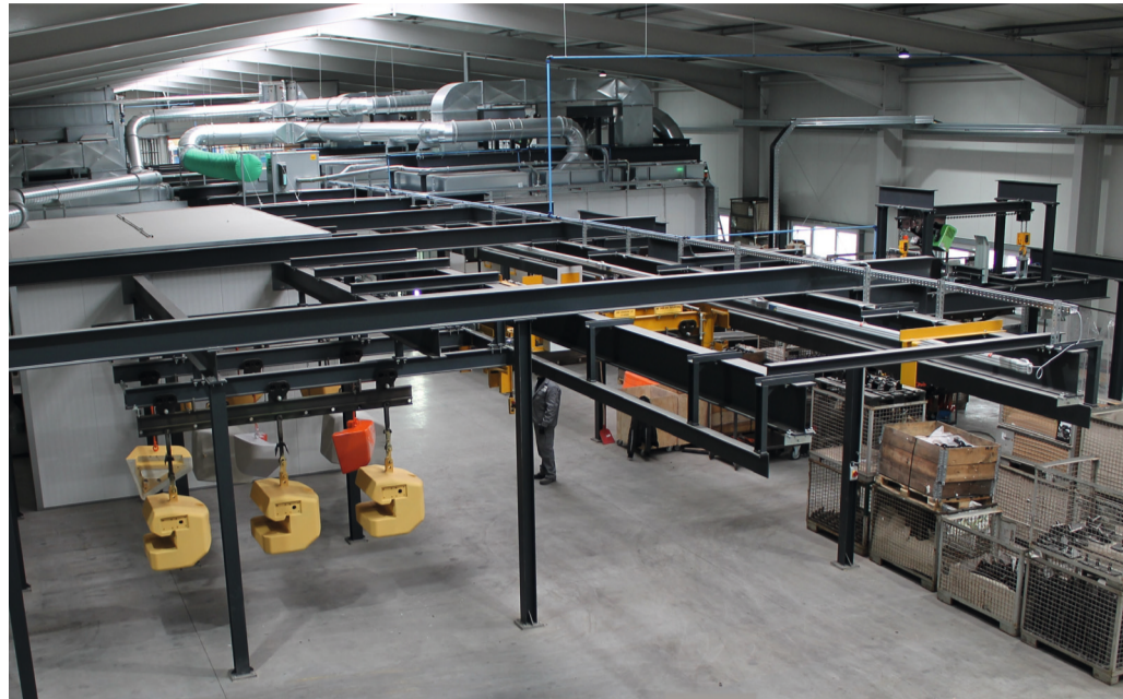
Blick in den Neubau: Die Anlage verfügt über eine Auf- und Abgabestation, Vorbehandlungsräume, eine Lackierkabine und einen Trockenofen mit vorgeschalteter Abdunstzone und ist erweiterbar.
