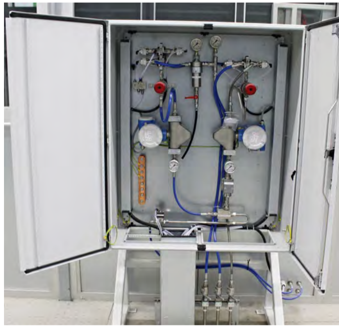
Eine druckgeregelte Anlage steuert die Mengen über die Eingabe des Materialdrucks. Quelle (zwei Bilder): L&S
