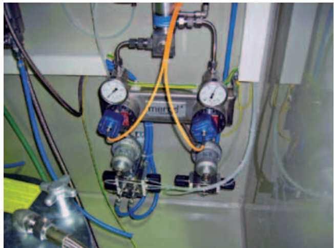
Das Dosiersystem mit speziellen Messaufnehmern und den galvanisch getrennten Signalleitungen
