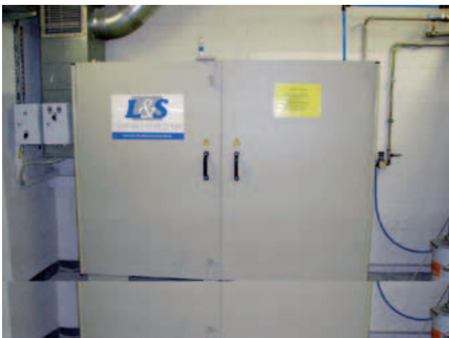
Der Isolierschrank mit allen Sicherheitseinrichtungen wurde eigens für die Anforderungen bei Windmüller & Hölscher konstruiert
